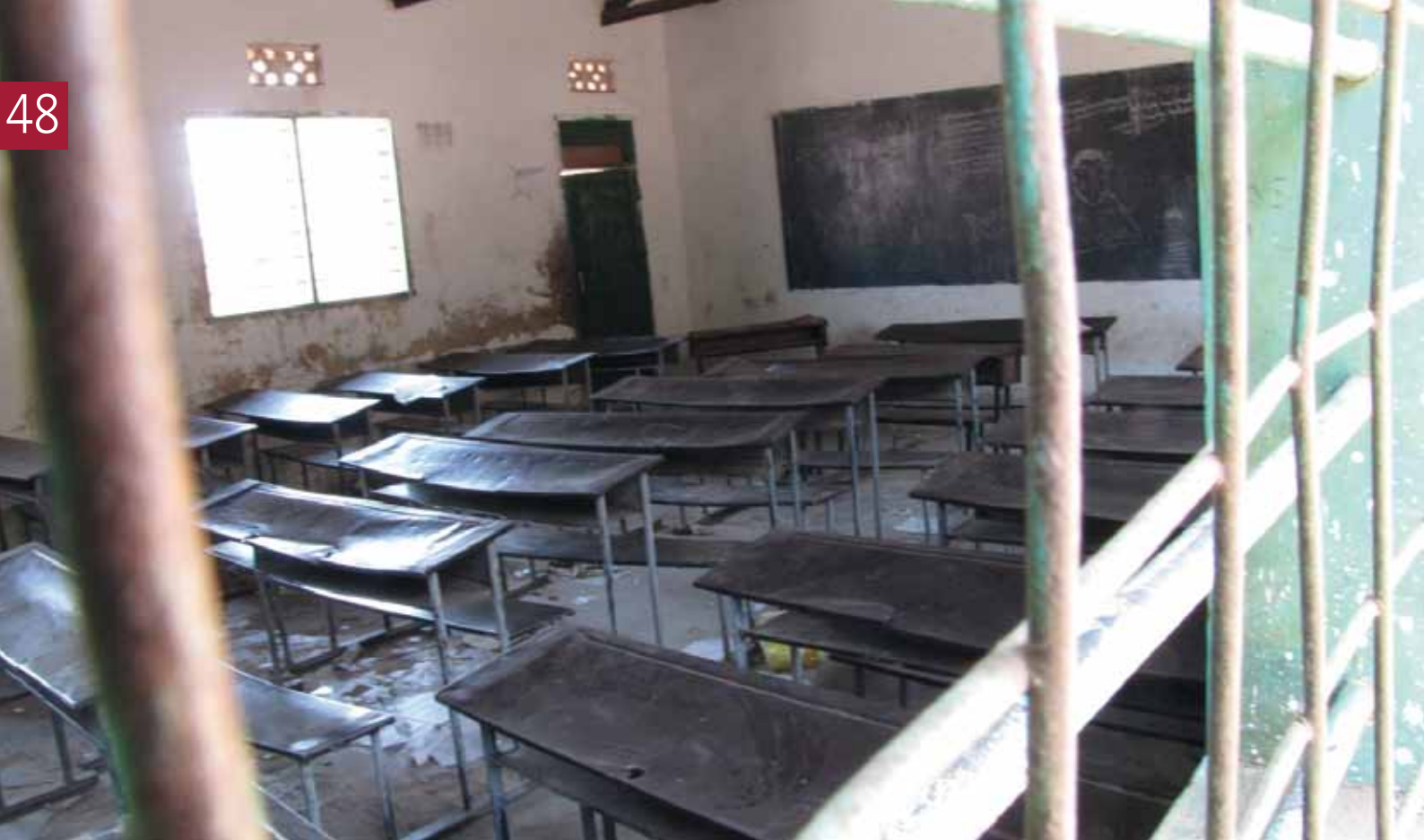
Verborgene Blechbänke, zerschlissene Tafel, vergitterte Fenster: unwürdig, dies eine Schulklasse zu nennen!
